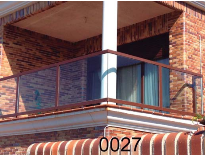
BB-0027: Balcón de acero macizo, tubos y lunas laminares, cercos ajunquillados de 40*30 mm., pasamanos, imprimacion "wash primer" y lacado al horno marrón.
